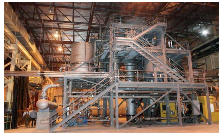
Instalacja Ensyn RTP w Renfrew, Ontario, przetwarzająca dziennie 100 ton odpadów drzewnych
