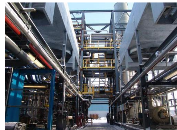
Instalacja Dynamotive w Guelph, Ontario przetwarzająca dziennie 200 ton biomasy
